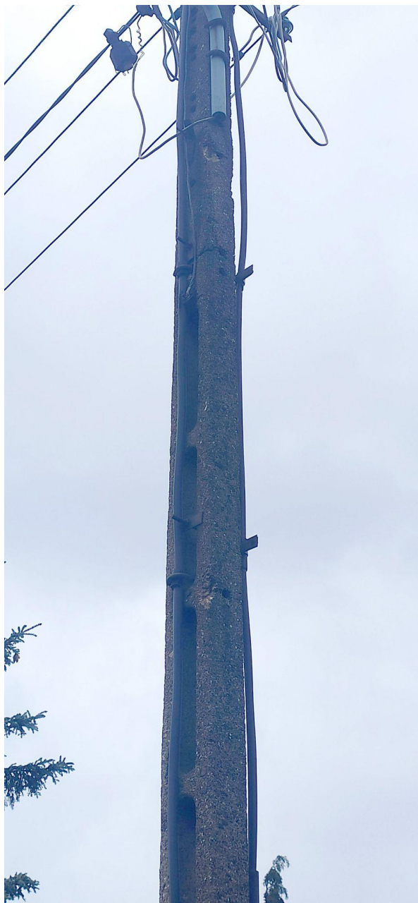
uszkodzenia na górze słupa
